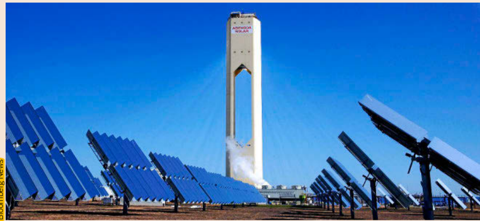
Planta termosolar de Abengoa en Sanlúcar la Mayor (Sevilla).
